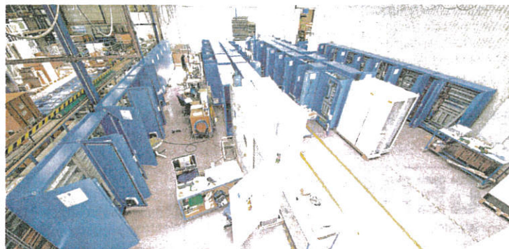
Einzigartige Lösungen werden in Ludersdorf gefertigt: Diese Schaltanlagen wurden in Lohnfertigung produziert.
