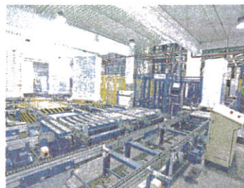
Modern: Ein vollautomatisches Palettenfördersystem.
