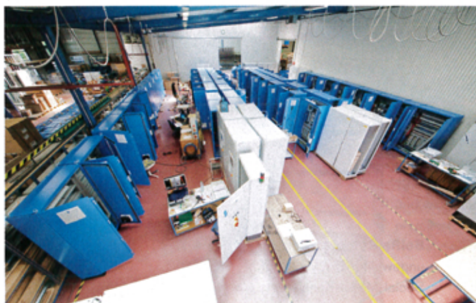
Der Kunde hat sich einen eigens definierten Blauton für die Schaltschränke gewünscht. Kein Problem für Rittal und BT-Anlagenbau.
