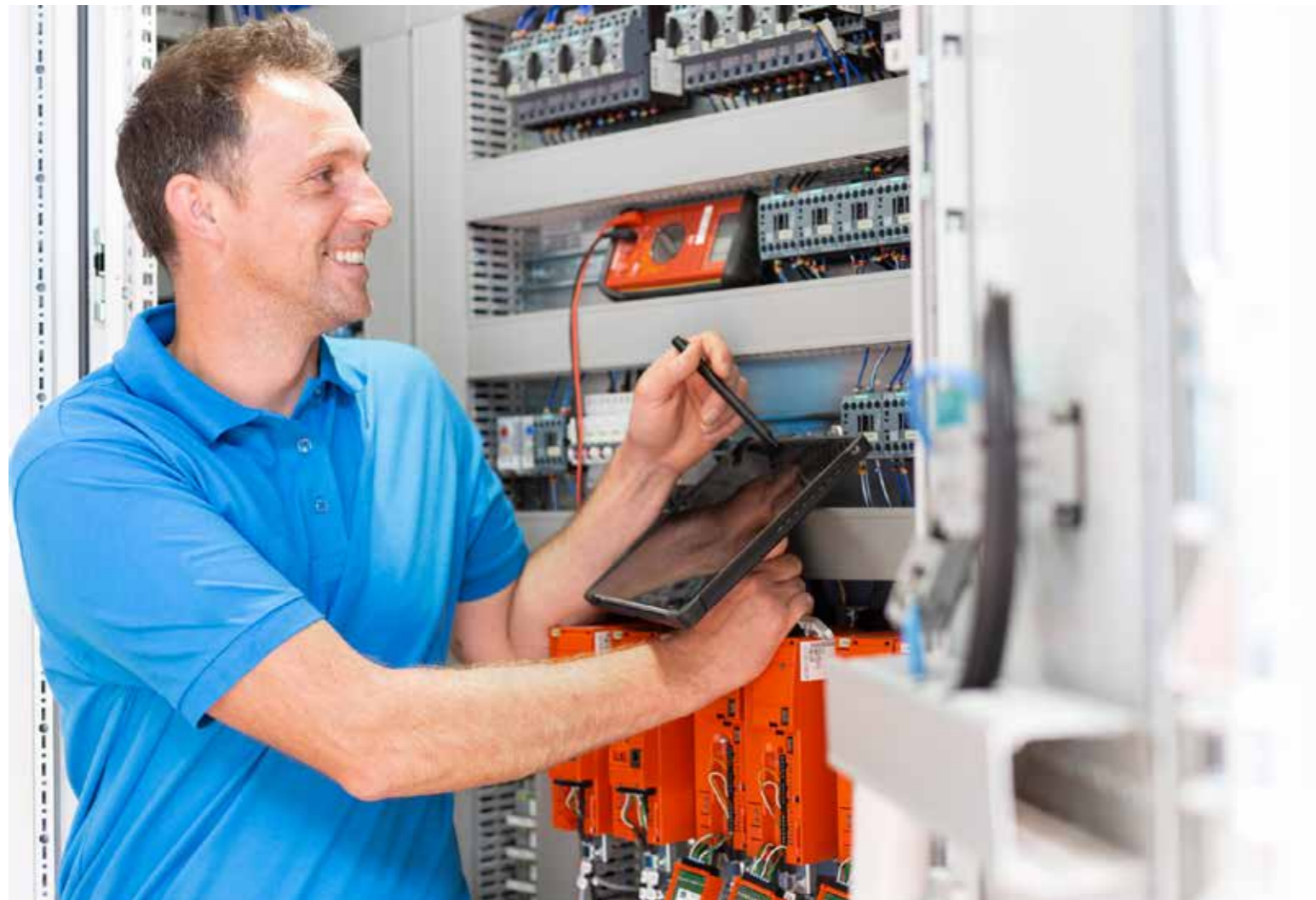
BT-Anlagenbau bietet Ihnen ein umfangreiches Service-Paket zur Minimierung Ihrer Kosten.
