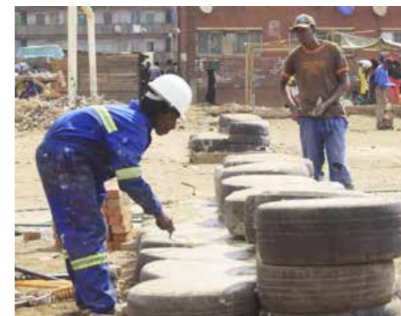
Bau der "Recycling-Reifen-Tribüne" für den Sportplatz Construction of the "recycled tyre stage" for the sports field
