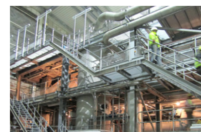
Innenbereich der Schlamm-trocknungsanlage
