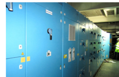
MCC Schaltschrankanlage der ANDRITZ AG
