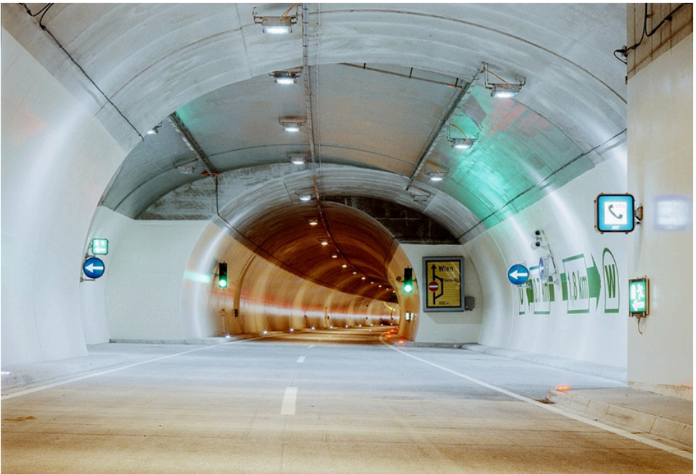
Hightech für Österreichs Tunnelinfrastruktur: In den kommenden Jahren wird BT-Systems die Tunnelinfrastruktur u. a. entlang der S6 mit modernster Schalttechnik beliefern © PKE Verkehrstechnik GmbH
